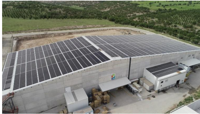
Şekil 16: Bir soğuk hava deposunda çatı GES uygulaması
